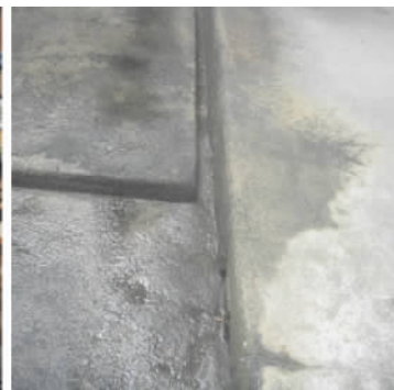
图6 天井排水明沟
